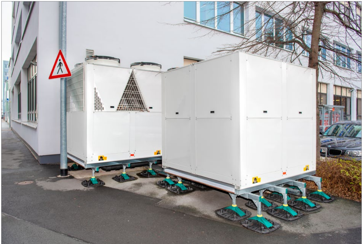
Unsere neue Kühlanlage
